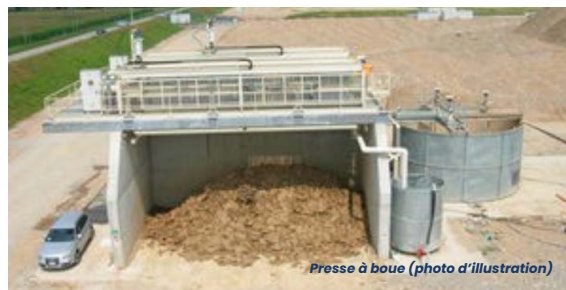
Stockage de boues en bassin
